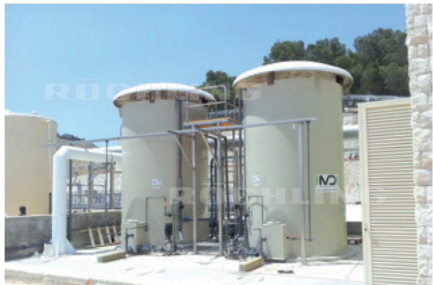
Filtres biologiques pour neutraliser les odeurs
