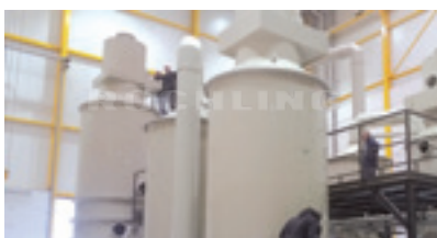
Laveurs de gaz d'une usine de biogaz en Polystone® P Homopolymère gris
