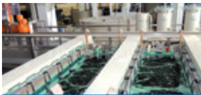
Cuve en Polystone® P dans une station de galvanoplastie sur matières plastiques
