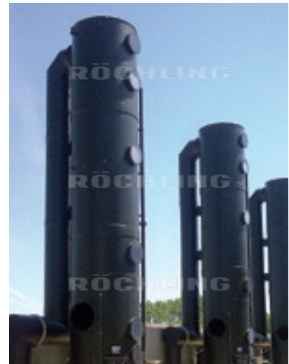
Polystone® G noir B 100 Purificateur d'air dans une station de tri des ordures ménagères
