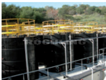
Polystone® G noir B 100-RC Cuves de stockage d'acide chlorhydrique
